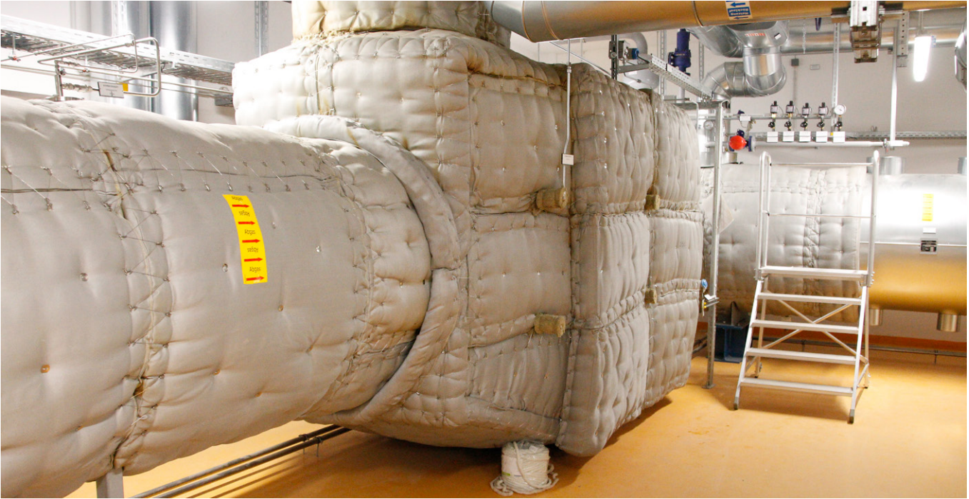
Abb.: Harnstoffbetriebener Katalysator zur Reduktion der Stickoxide mit optimaler Wärmeisolierung im Blockheizkraftwerk „Jungfernwiese“
