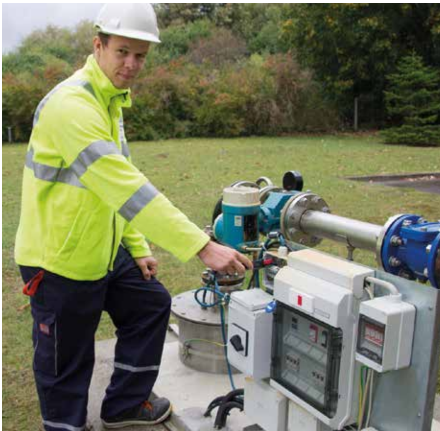
Abb.: Max Krüth misst mit der Amperezange die Stromaufnahme der Pumpe am Wasserbrunnen.
