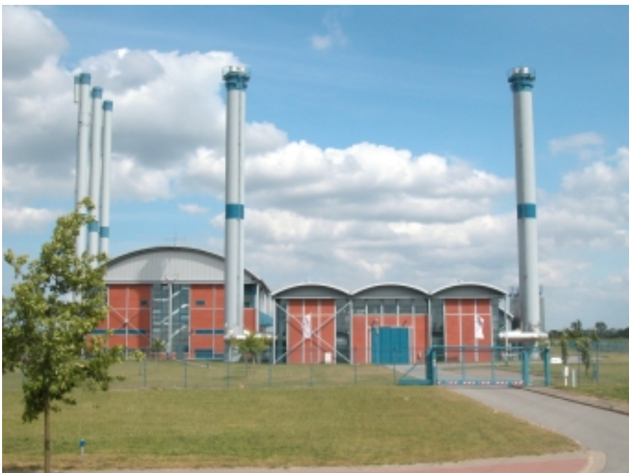
Bild: Heizkraftwerk Am Helmsäger Berg
